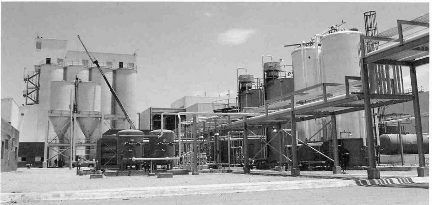
Planta de tratamiento de agua.
